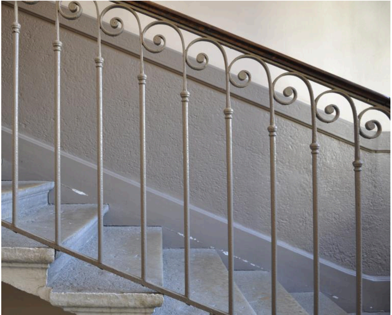
Immeuble sur rue : le garde-corps de l'escalier
