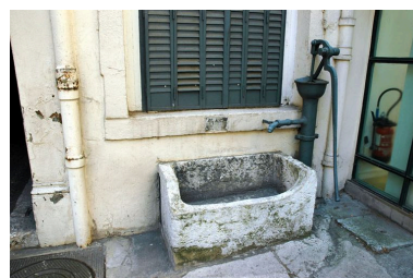
La cour, côté sud : pompe et bassin Phot. Véronique Belle IVR82_20076901027NUCA
