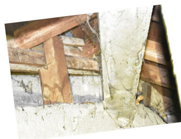
Charpente de toit en béton, faitage : gros plan sur un chanfrein à congé (détail de modénature que l'on peut repérer à différents endroits dans l'établissement). Phot. Bénédicte Renaud-Morand IVR84_20226301725NUCA
