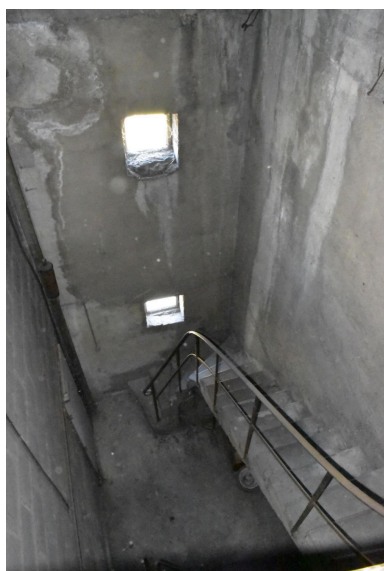
Escalier d'accès à la charpente de toit du bâtiment principal, avec un départ au troisième étage. Phot. Bénédicte Renaud-Morand IVR84_20226301726NUCA
