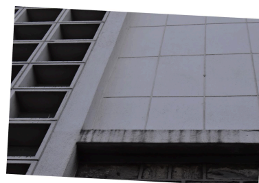
Façade principale sur le boulevard. Sur ce détail, on distingue les faux joints tracés sur le "crépissage au mortier de ciment et peinture silixore" (termes d'un courrier de l'architecte à l'inspecteur principal dans lequel A. Verdier décrit une "solution de pauvreté"). Phot. Bénédicte Renaud-Morand IVR84_20226301741NUCA
