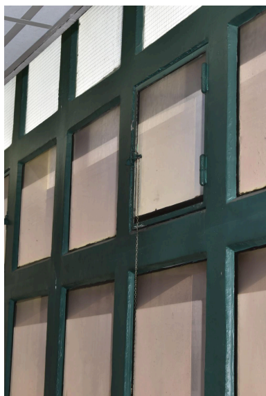
Détail du système d'ouverture d'une des claustras éclairant le parloir. Phot. Bénédicte Renaud-Morand IVR84_20226301721NUCA
