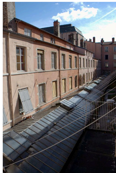
Vue partielle extérieure des immeubles de la partie nord du passage, depuis l'ouest Phot. Catherine Guégan IVR82_20096900536NUCA
