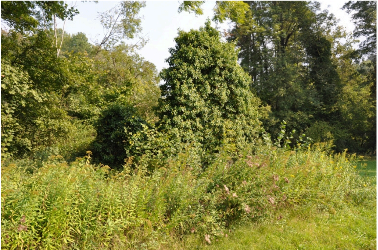
Vue générale du moulin envahi par la végétation
