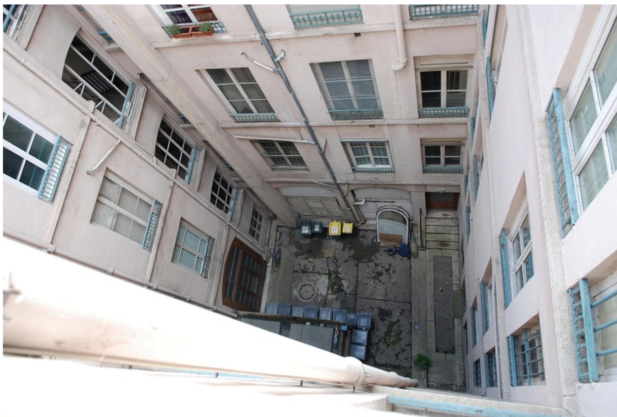
Vue en plongée de la cour, commune aux immeubles sis 3 rue Gasparin et 86 rue du Président-Edouard-Herriot
