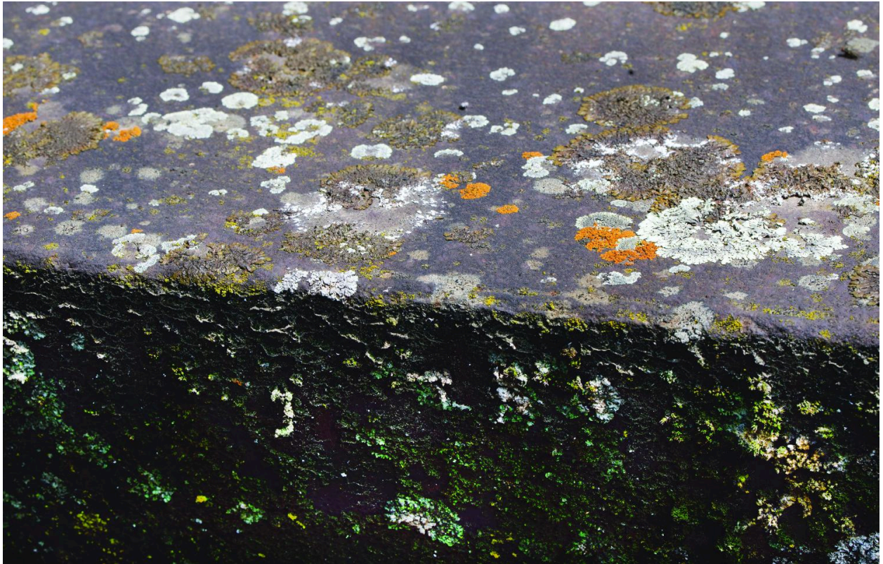
Altération de la surface.
