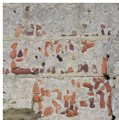
Détail du pignon ouest du logis (utilisation de débris de tuiles pour charger l'enduit). Phot. Eric Dessert IVR82_20084201213NUCA
