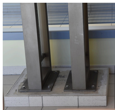
Installation n°5 : détail des platinas d'ancrage au sol Phot. Catherine Guégan IVR84_20241500058NUCA
