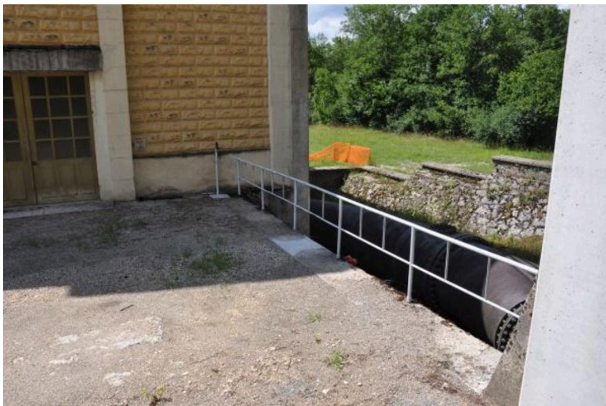
Arrivée de la consuite forcée dans la centrale.
