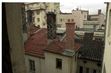
A droite, toiture depuis l'escalier de l'immeuble sis 8 rue de l'Ancienne-Préfecture Phot. Véronique Belle IVR82_20076901188NUCA
