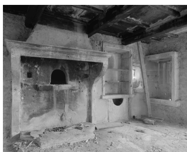
Pièce principale du logis : détail de la cheminée, du four à pain, du potager et de la souillarde. Phot. Alain Franchella IVR82_20002600354X
