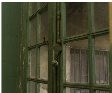
Détail de l'espagnolette de la fenêtre du premier étage Phot. François Blanchetière IVR82_20016901552NUCA
