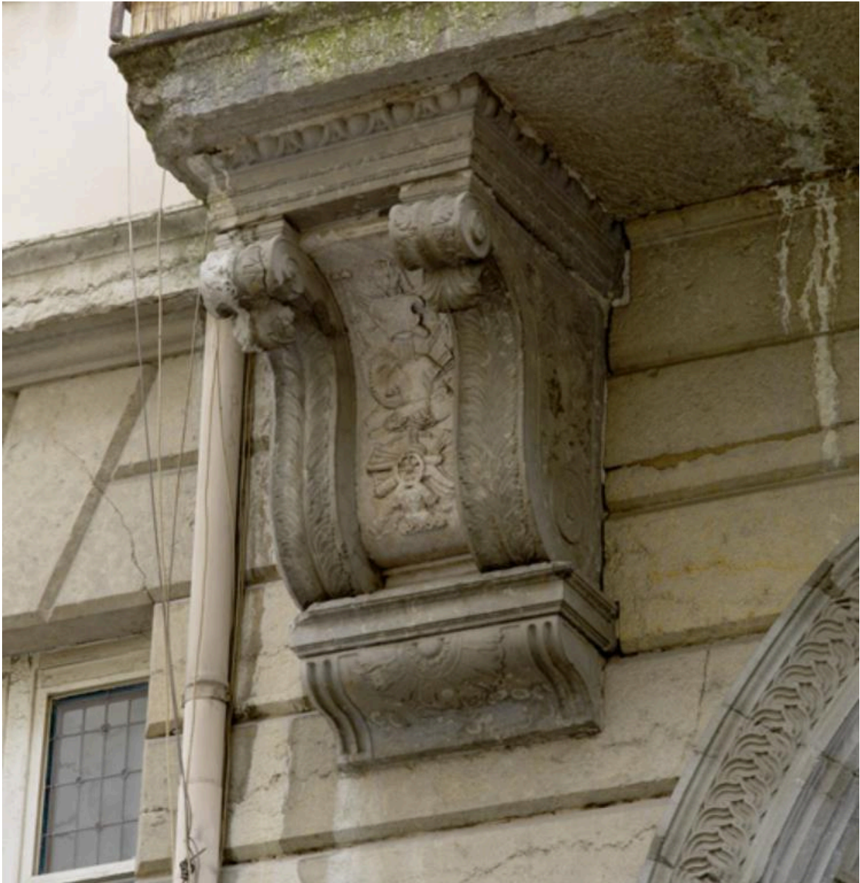
Portail : balcon, console gauche, vue générale
