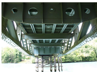
Vue de dessous, travée gauche (depuis la rive gauche) Phot. B. Decrock IVR82_20100100457NUCA
