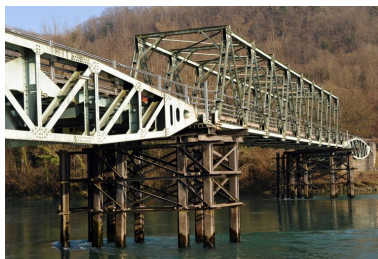
Vue partielle, de côté, travée centrale, face aval (depuis la rive droite) Phot. G. Gellert IVR82_20100100448NUCA
