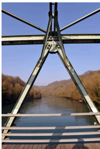
Travée centrale, de dessus, vue de détail : structure métallique, de face Phot. G. Gellert IVR82_20100100454NUCA
