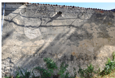
Mur de clôture enclavé entre la maison du jardinier et l'orangerie Phot. Magali Delavenne IVR84_20200101136NUCA
