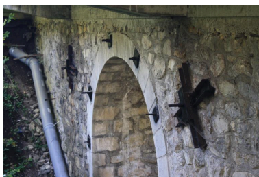
Pont d'Essert-Romand, détails bandeau et tirants d'enserrement Phot. Benoît Huraut IVR84_20207401070NUCA
