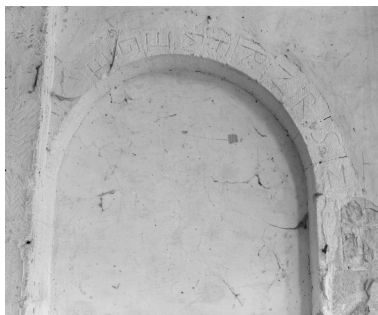
Nef, 1ère travée : arc de l'ancienne porte latérale droite, portant des marques de tâcherons
