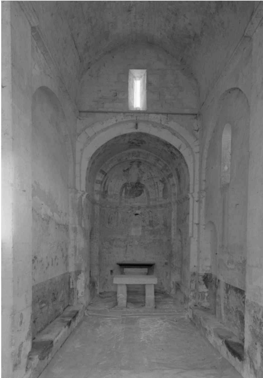
Vue intérieure depuis l'entrée, après restauration du sol et dégagement des peintures.
