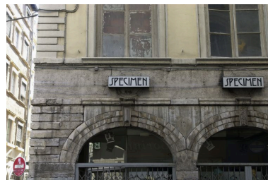
Façade principale, détail des arcades du 1er niveau Phot. Bernard Ducouret IVR82_20046900808NUCA
