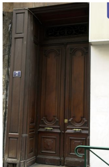
Façade sur la rue Lanterne, détail de la porte Phot. Bernard Ducouret IVR82_20036901200NUCA
