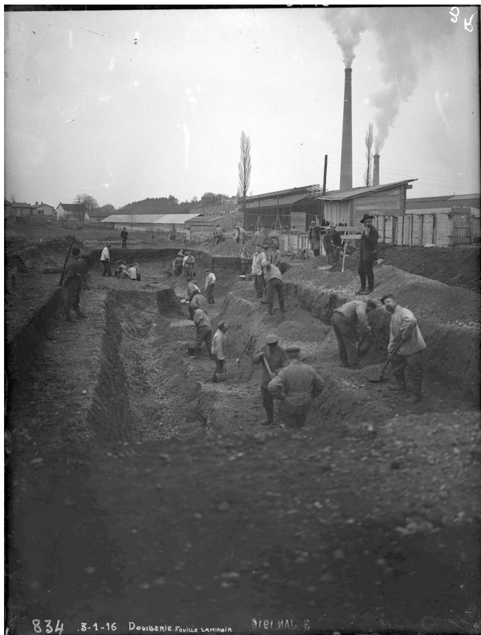
Vue générale de l'usine, douillerie - fouille laminoir, AD 69 : série 158 J. plaque de verre, usine Tréfinmétaux AD Rhône. 158 J
