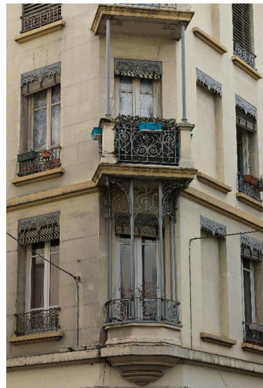
Vue rapprochée des balcons superposés sur l'angle d'ilot : ferronneries Art Nouveau Phot. Eric Dessert IVR84_20166901364NUCA
