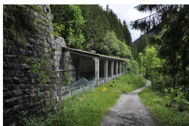
Paravalanche situé entre l'aqueduc et l'entrée du tunnel des Tines Phot. Samir Mahfoudi IVR84_20207401180NUCA
