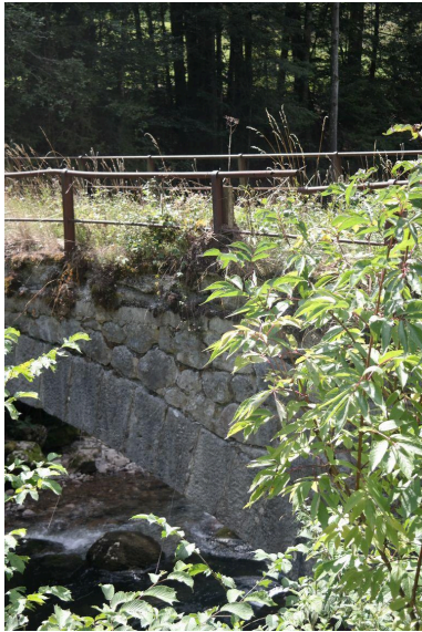
Pont des Portes ancien, détail tablier et garde-corps Phot. Pascale Renard IVR84_20207401027NUCA
