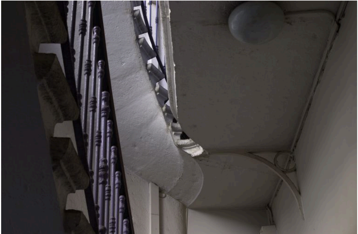
Escalier, départ de la volée depuis le palier du 4e étage, vue par-dessous
