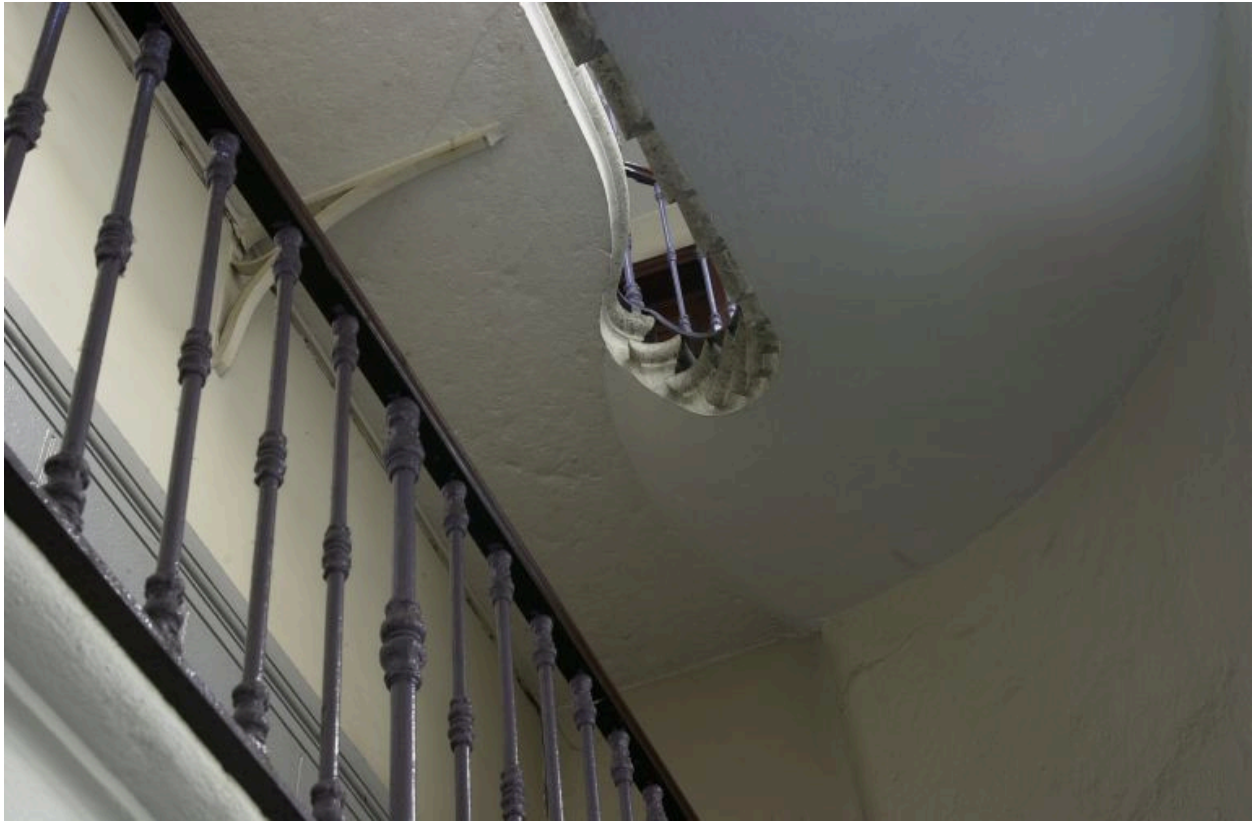
Escalier, arrivée de la volée sur le palier du 5e étage, vue par-dessous
