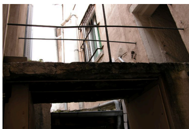
Passerelle reliant l'escalier de AD 7 A à l'étage de AD 7 B Phot. Maryannick Chalabi IVR82_20046904112NUCA
