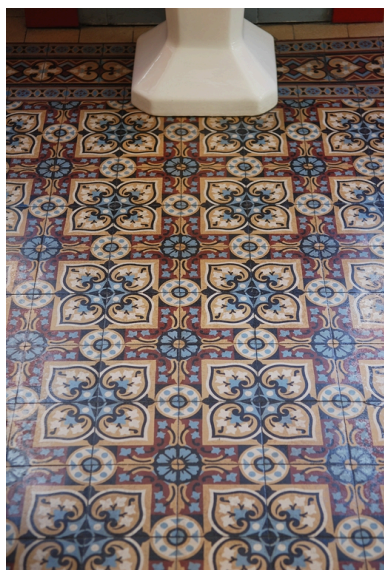
Appartement du premier étage : détail du revêtement de sol Phot. Véronique Belle IVR82_20096904647NUCA
