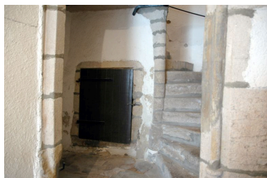
Puits dans le mur- noyau de l'escalier en vis. Phot. Simone Hartmann-Nussbaum IVR82_20114200614NUCA
