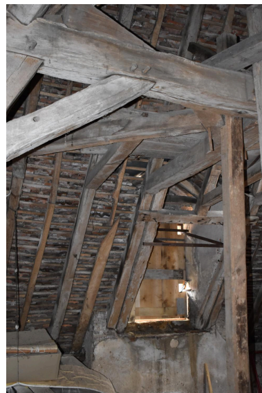
Vue de détail de la charpente du comble : croupe au niveau de la lucarne. Phot. Maryse Durin-Tercelin IVR84_20250300603NUCA
