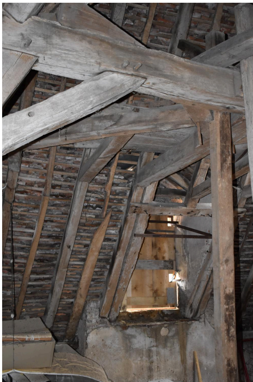
Vue de détail de la charpente du comble : coupe au niveau de la lucarne.
