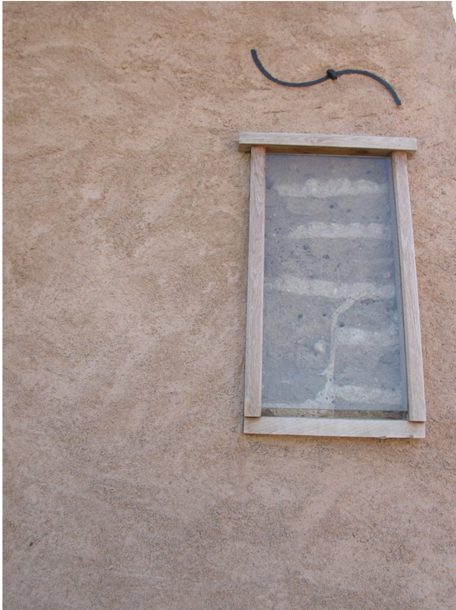
Détail de l'élévation : fenêtre d'observation du pisé aménagée lors de la réfection de l'enduit en 2006.
