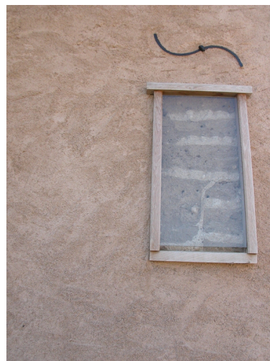
Détail de l'élévation : fenêtre d'observation du pisé aménagée lors de la réfection de l'enduit en 2006. Phot. Caroline Guibaud IVR82_20134200822NUCA
