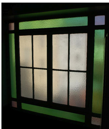
Vue intérieure : fenêtre en verre coloré éclairant la cage d'escalier Phot. Magali Delavenne IVR82_20146902897NUCA
