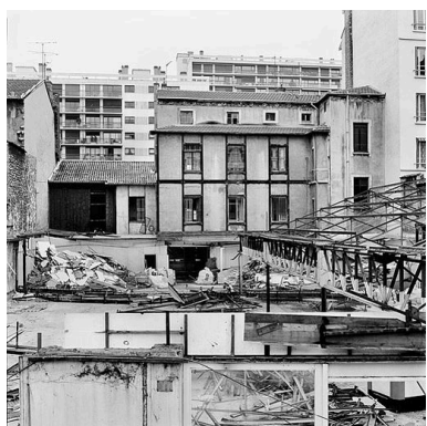
L'élévation postérieure après démolition de l'entrepôt donnant sur la rue Turbil Phot. Didier Gourbin IVR82_20036903281X
