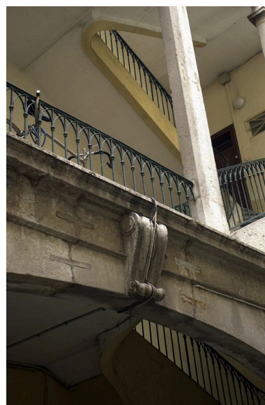
Cage d'escalier : agrafe ornant l'arc du rez-de-chaussée, côté cour Phot. Véronique Belle IVR82_20076901172NUCA
