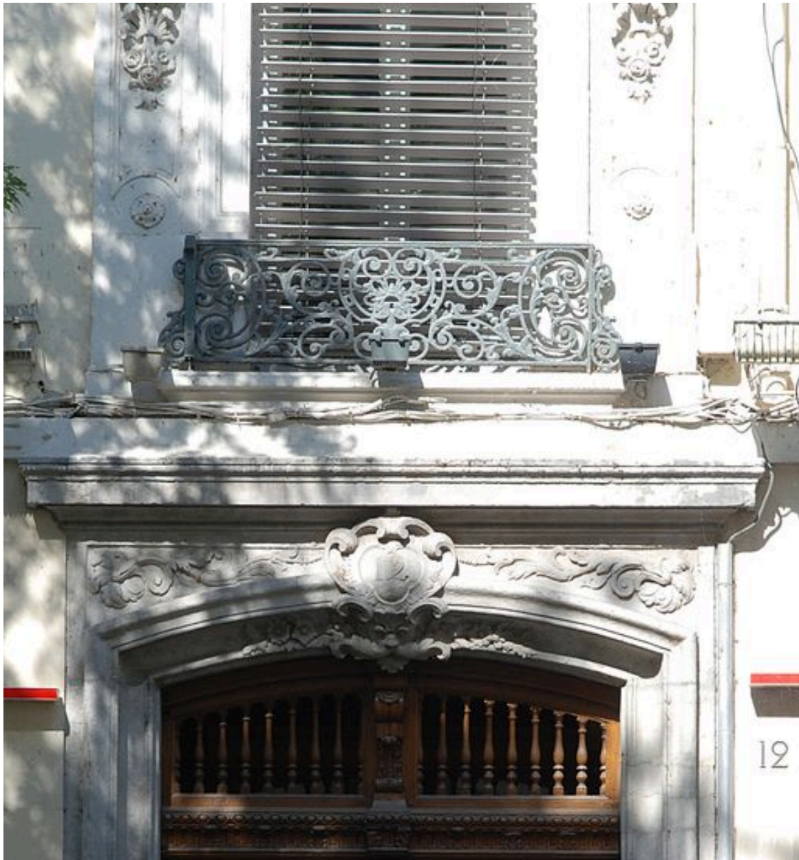
Elévation est : linteau de porte et garde-corps
