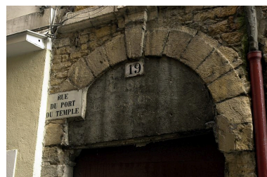
Détail du tympan du n°19 portant l'inscription L'HOSTEL DE LA MONNOYE, pierre mouillée Phot. Véronique Belle IVR82_20086901293NUCA
