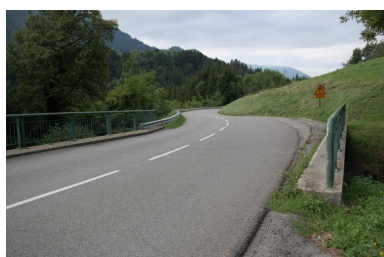
Pont de la Corbassière, vue de la chaussée et des gardes-corps Phot. Pascale Renard IVR84_20207401242NUCA
