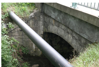
Pont de la Corbassière, détail de la voûte Phot. Pascale Renard IVR84_20207401243NUCA
