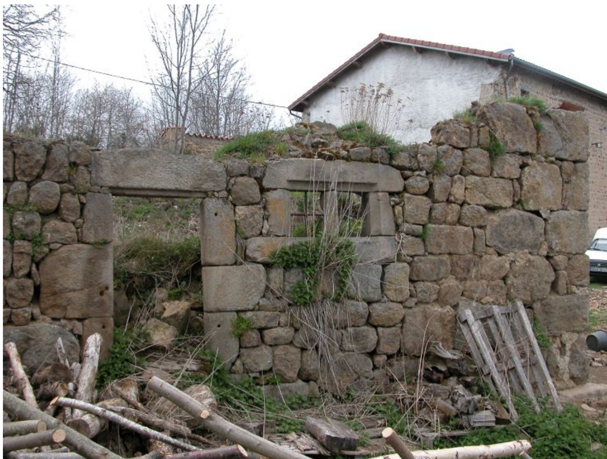
Bâtiment en ruine avec remploi d'éléments d'encadrement anciens.
