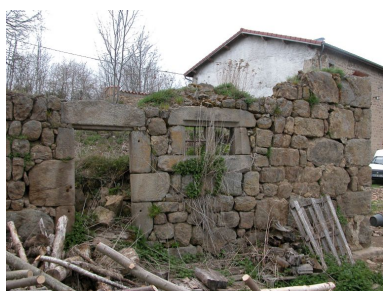
Bâtiment en ruine avec remploi d'éléments d'encadrement anciens. Phot. Thierry Monnet IVR82_20114202001NUCA
