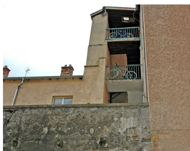
Repos du premier et du second étage vue depuis la cour mitoyenne au nord.
