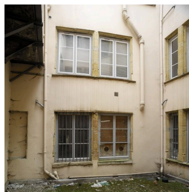
Cour, corps mince ouest, élévation des niveaux 2 et 3 Phot. Didier Gourbin IVR82_20056901473NUCA
