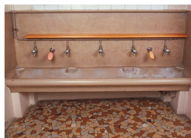
Ecole maternelle : les lavabos destinés à l'usage des enfants, rez-de-chaussée Phot. Jean-Marie Refflé IVR82_20016902295XA
