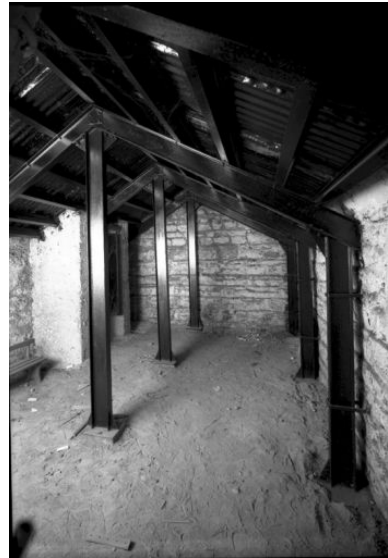
Ecole maternelle : vue partielle d'une cave construite en pierre et renforcée par une charpente métallique Phot. Jean-Marie Refflé IVR82_20016902299P
