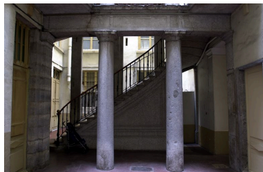
Cage d'escalier au niveau du rez-de-chaussée, vue depuis la cour où sera installé l'ascenseur Phot. Véronique Belle IVR82_20036902019NUCA
