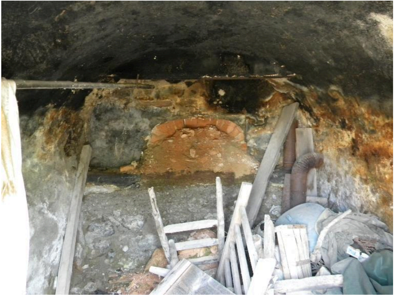
Vue de l'intérieur du four.
