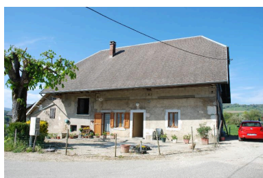
La Marchière, Ferme, 2013 E1 27, 318, 319, 333. Vue d'ensemble du logis. Phot. Thierry Monnet IVR84_20167302115NUCA
