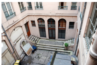
Elévation sud de la cour, commune à l'immeuble sis 86 rue du Président-Edouard-Herriot Phot. Véronique Belle IVR82_20096904711NUCA
