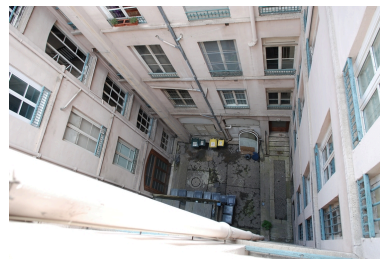
Vue en plongée de la cour, commune avec les immeubles sis 9 place des Jacobins et 86 rue du Président-Edouard-Herriot Phot. Véronique Belle IVR82_20096904687NUCA
