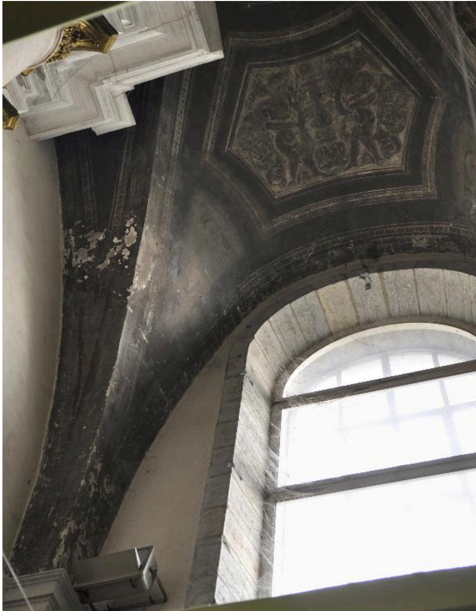
Voûte, angle nord-ouest : détail de l'état de conservation des peintures : perte de matière, encrassement généralisé
