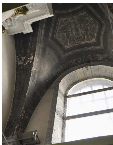
Voûte, angle nord-ouest : détail de l'état de conservation des
