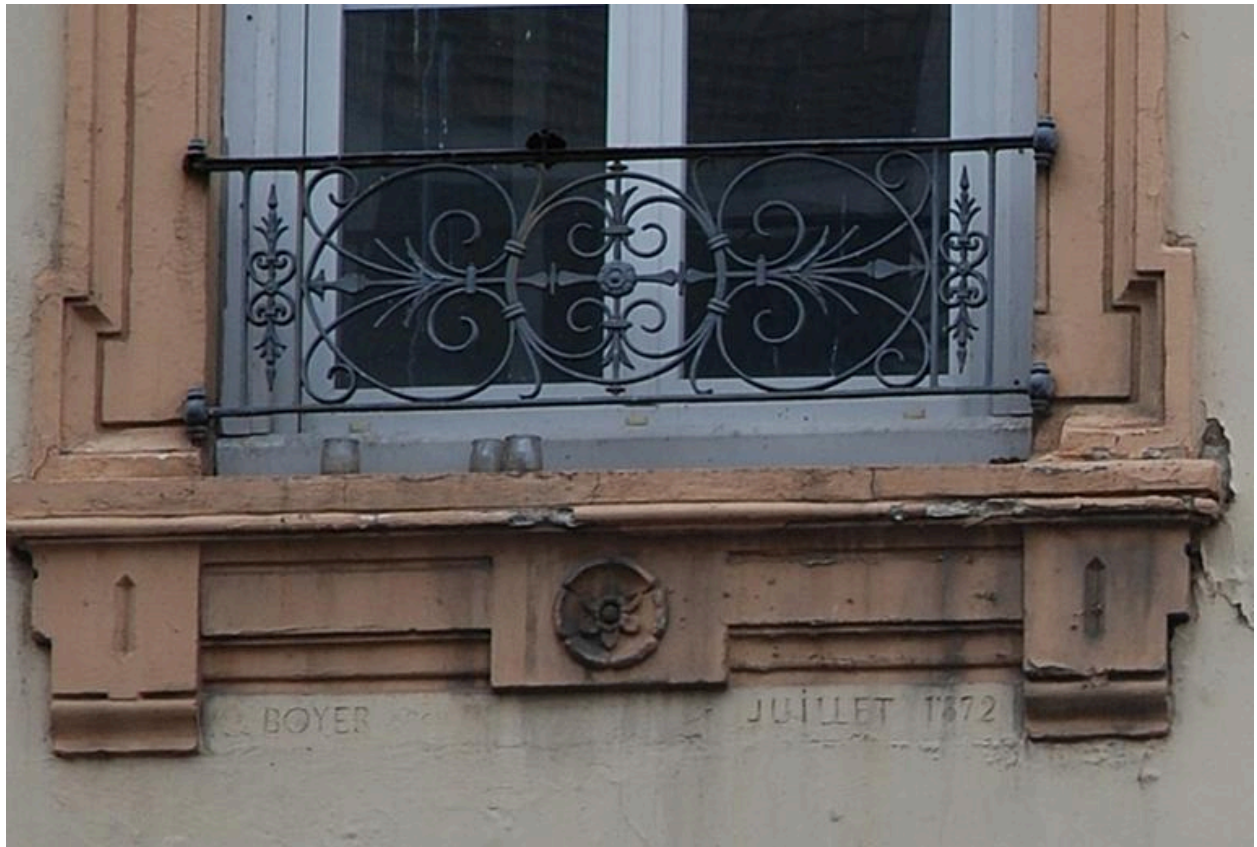
Élévation nord, détail : signature de l'architecte et date portée, sous l'encadrement d'une fenêtre du premier étage
