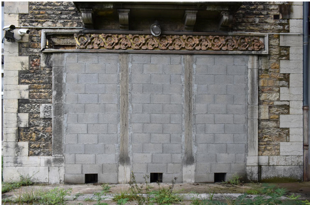
Elévation postérieure : baie jumelée triple (aujourd'hui murée) avec décor de céramique sur le linteau
