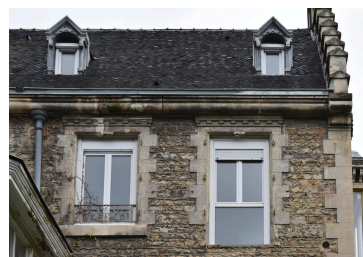
Elévation latérale sud-ouest : baies du 2e étage et toit Phot. Catherine Guégan IVR84_20246901105NUCA
