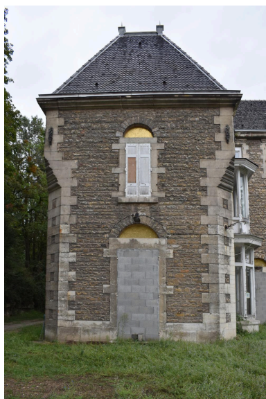
Elévation latérale sud- ouest, détail du pavillon sud Phot. Catherine Guégan IVR84_20246901097NUCA
