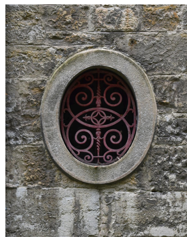
Elévation antérieure : détail de l'oculus éclairant la cage de l'escalier en vis au rez-de-chaussée Phot. Catherine Guégan IVR84_20246901091NUCA
