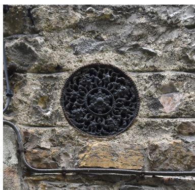
Elévation antérieure : grille de ventilation en fonte Phot. Catherine Guégan IVR84_20246901092NUCA
