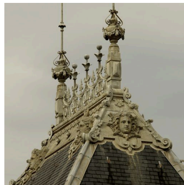
Détail de la toiture du pavillon d'angle oriental (épi de faitage et crête) depuis le toit du Grand Bazar Phot. Eric Dessert IVR82_20046901107NUCA
