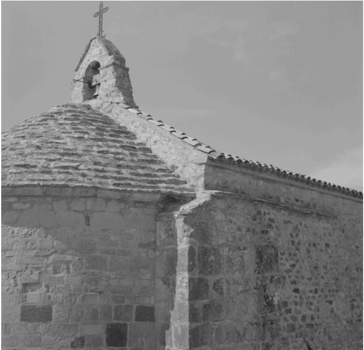
Vue partielle prise du nord-est : détail des parties hautes du mur gouttereau et de l'abside, et clocher-mur.
