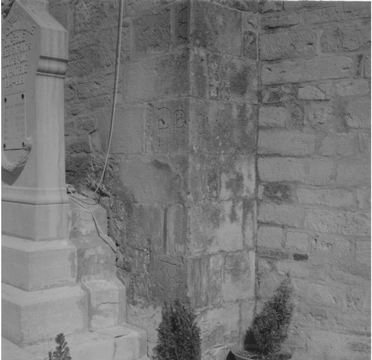
Chaîne d'angle à la jonction de la nef et de l'abside, côté sud, présentant des marques lapidaires, dont l'inscription PONCIUS, sans doute la signature du tâcheron.
