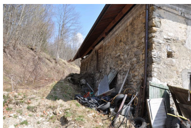
Détail de la façade postérieure de l'ancien bâtiment du moulin Phot. Samir Mahfoudi, Autr. Samir Mahfoudi
